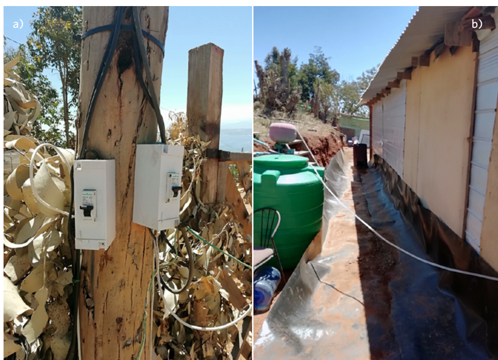
Imagen 3. a) Sistema eléctrico para caso de sobrecarga. b) Sistema de drenaje de aguas lluvias en Campamento Viento Fuerte, Valparaíso
