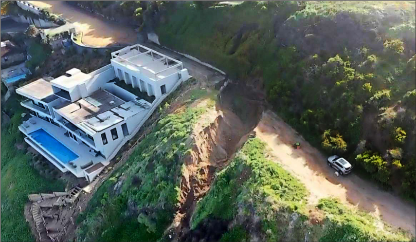
DESPRENDIMIENTO. — El colapso de un ducto privado para evacuar lluvias fue causa, según las autoridades, del socavón que tuvo lugar en Cachagua en una duna.
